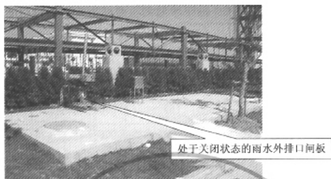
图 A.28 雨水外排口闸板阀
